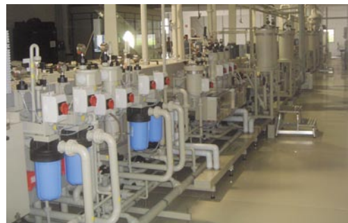
Rückseitenansicht der neuen smarttin ® -Anlage
