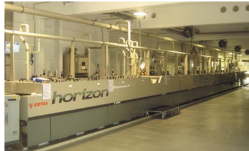
Gesamtansicht der neuen smarttin ® -Anlage
